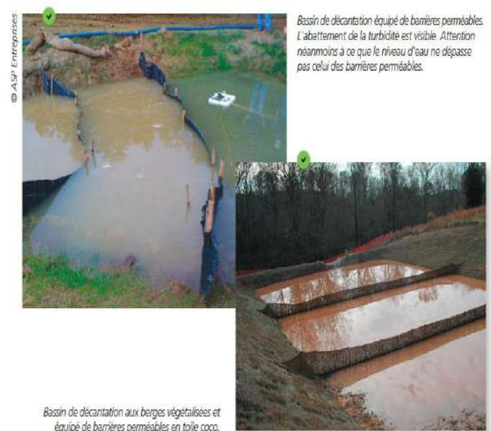
Figure 73 : Bassins de décantation équipés de barrières perméables
